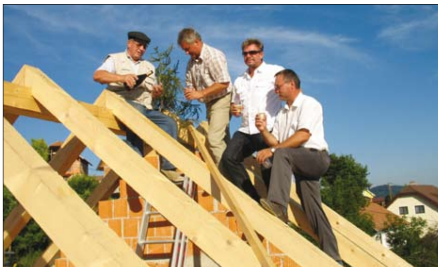
Gradnja poteka po predvidenih rokih, tako da se bodo lahko prizadeti vselili v novo hišo predvidoma že konec oktobra.
